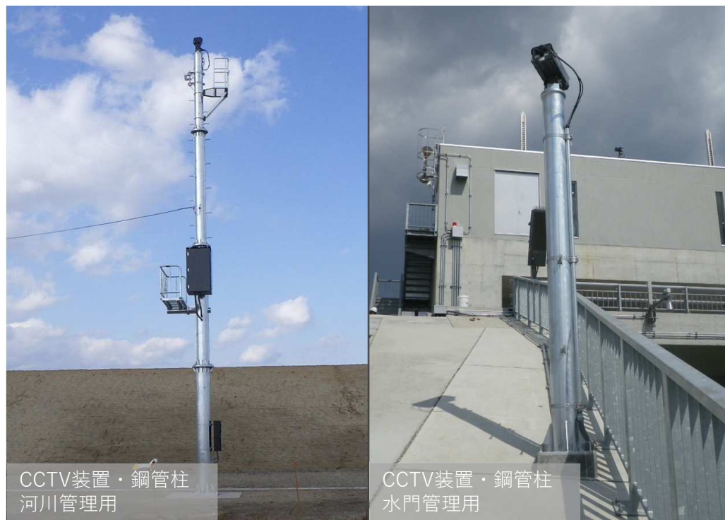
河川管理用CCTV設備 (宮城県 名取川河口 関上水門 他)
