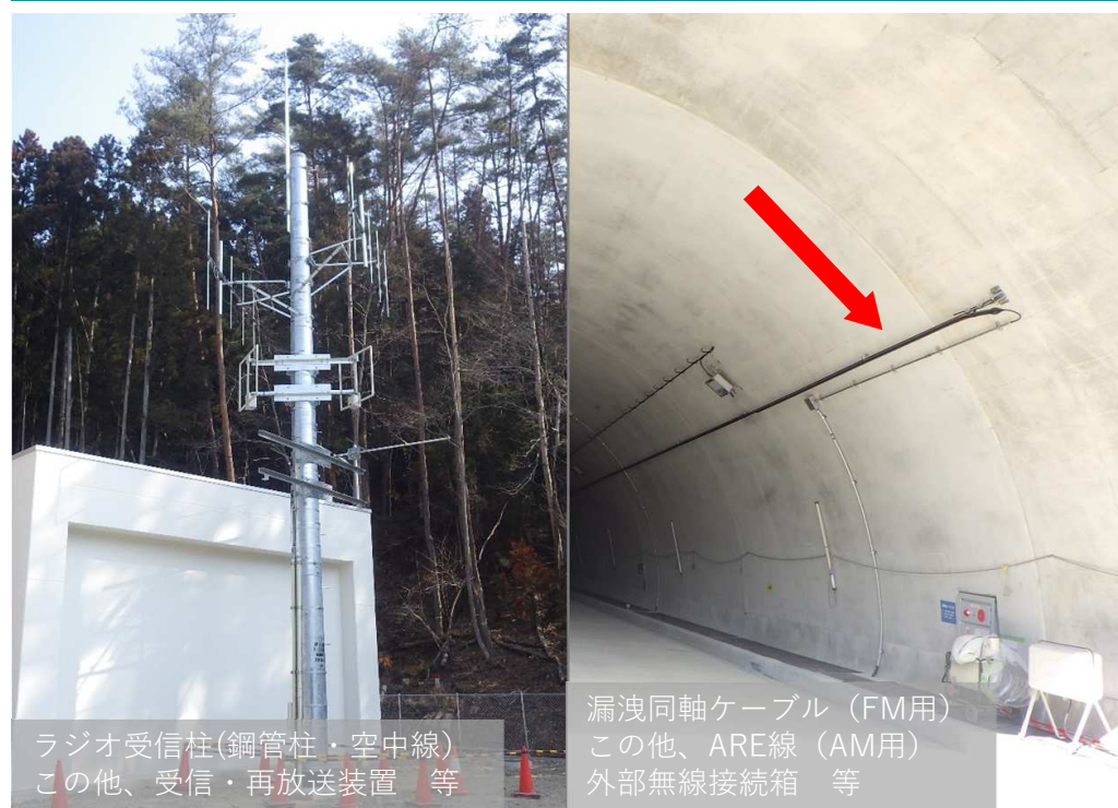
ラジオ再放送設備 (三陸沿岸自動車道 新唐桑トンネル 他)
