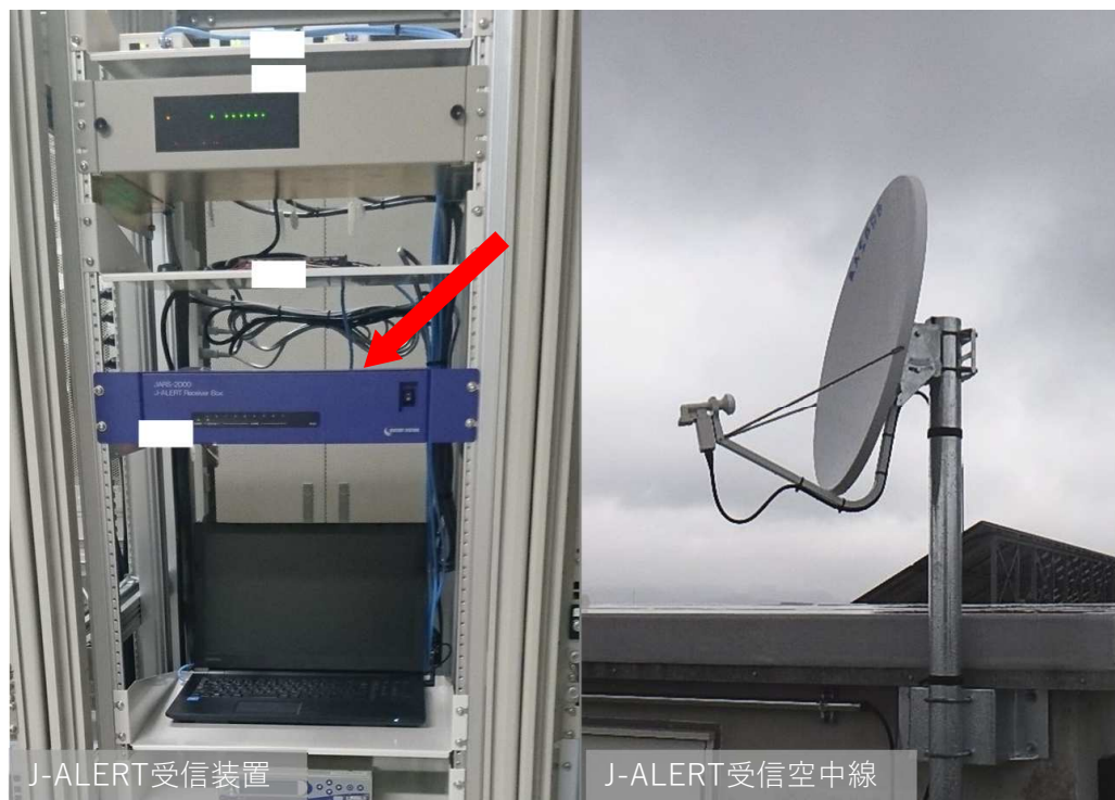
J-ALERT受信設備 (国・地方自治体)
