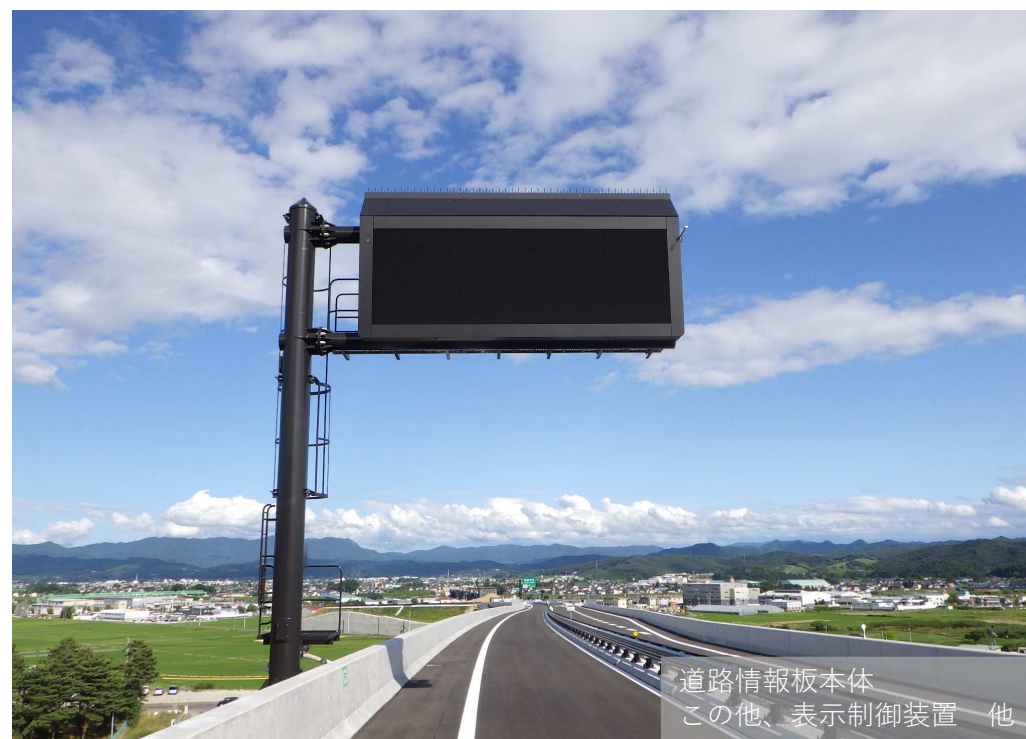
道路情報板設備 (東北中央自動車道 伊達桑折IC 他)
