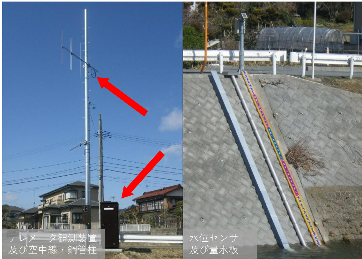
テレメータ水位観測局設備 (国・地方自治体)
