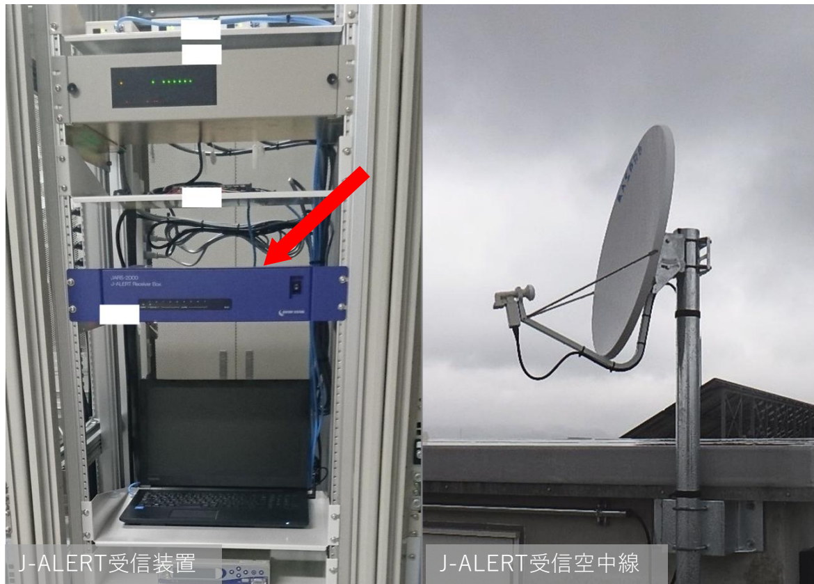
J-ALERT受信設備 (国・地方自治体)
